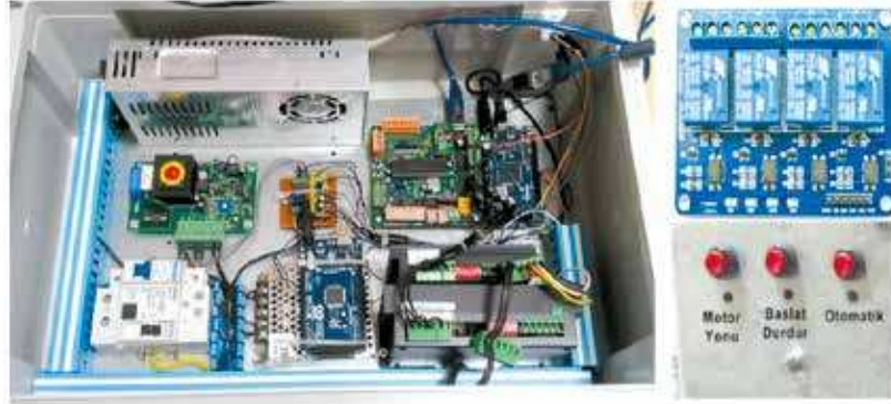
Şekil 3. Mikrodenetleyici tabanlı örnek bir CNC tezgâh kontrol ünitesi
